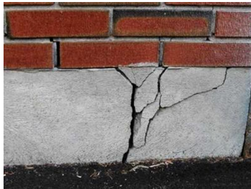
Фиг. 10. Пукнатини в основата на къща следствие на набъбване на почвата
